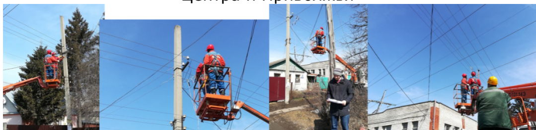
Рисунок 2 - Измерения на 0,4 кВ от ТП-982, под влиянием линии 110 кВ «МРСК Центра и Приволжья»
