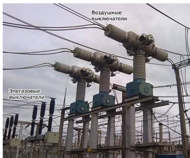
Рис. 1. Элегазовые и воздушные выключатели на подстанции «Факел»
